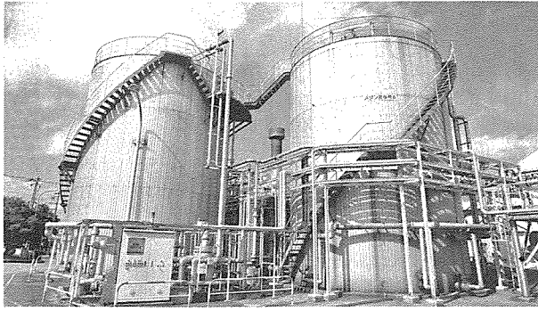
現在のメタン発酵槽2基
